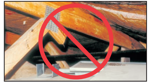
DON'T cut truss members. The modification shown in this photo needs a repair. NO corte los miembros de los trusses. La modificación mostrada en esta foto necesita una reparación.
